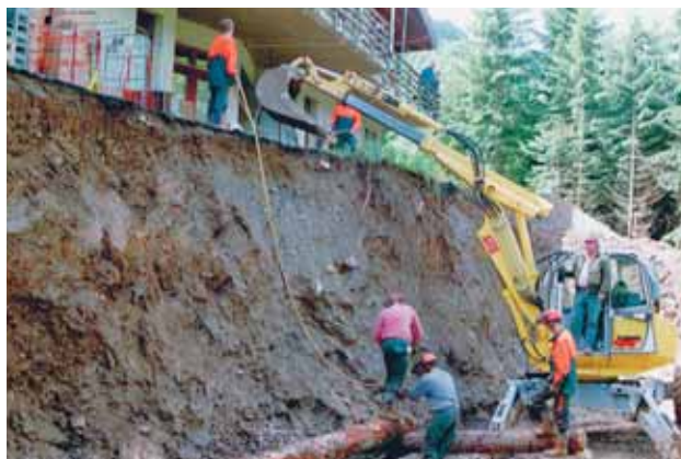
Le terrain a glissé derrière le Perroquet! Les bûche-rons ont engagé Jean-Pierre et son araignée afin de stabiliser la montagne (juin 2001).
