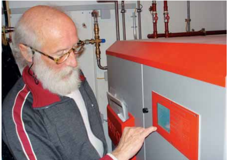
M. Schneebeli devant sa nouvelle installation.
